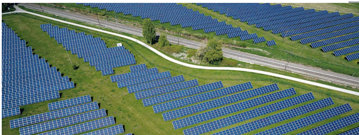
Painéis fotovoltaicos instalados no Ceará: condições de geração solar e eólica estão entre as melhores do mundo, mas há restrições na capacidade de escoamento da produção, que precisam ser solucionadas
